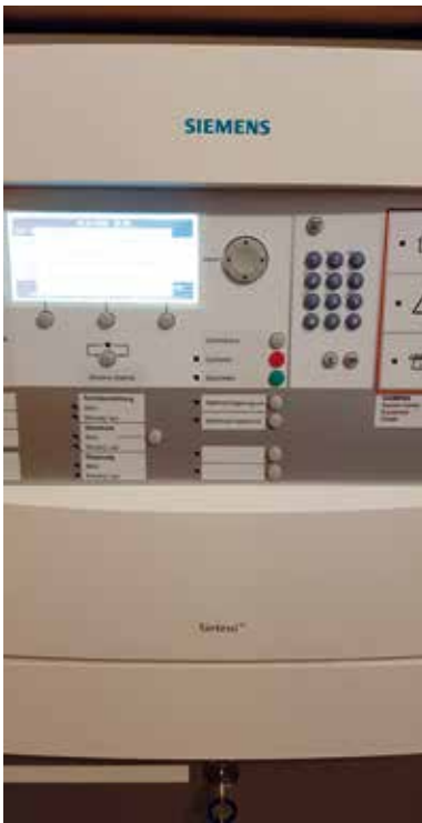
Neuste Technik in der Kirche: Für den Brandfall bestmöglich gerüstet
